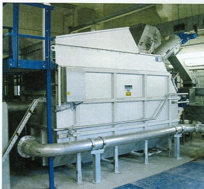
HUBER ROTAMAT® Membrane Screen RoMem Pro 1600, installiert auf dem Gemeinschaftsklärwerk Bitterfeld-Wolfen.
